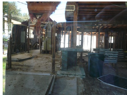
被災家屋内の被害はすざましい状況だった
